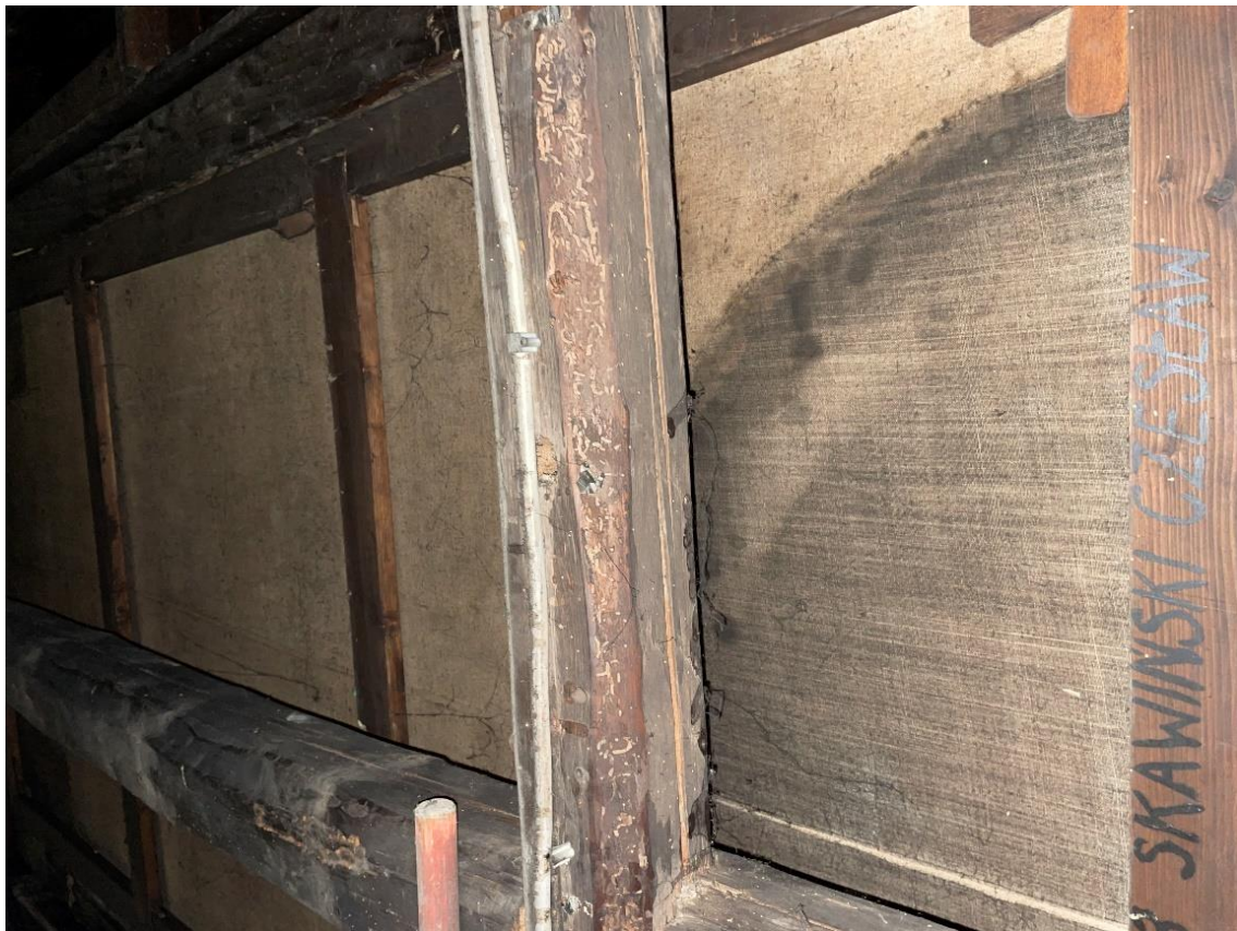
Fot.14. Więclawice Stare, kościół p.w. św. Jakuba Apostoła, ołtarz główny. Na zdjęciu widoczne zniszczenia belek konstrukcyjnych wzmacniających szafę ołtarzową od tyłu (tunele wydrążone przez owady) oraz fragment odwrocia obrazu przedstawiającego św. Jakuba (zauważalne silne zabrudzenie podobrazia nalotem kurzu).
