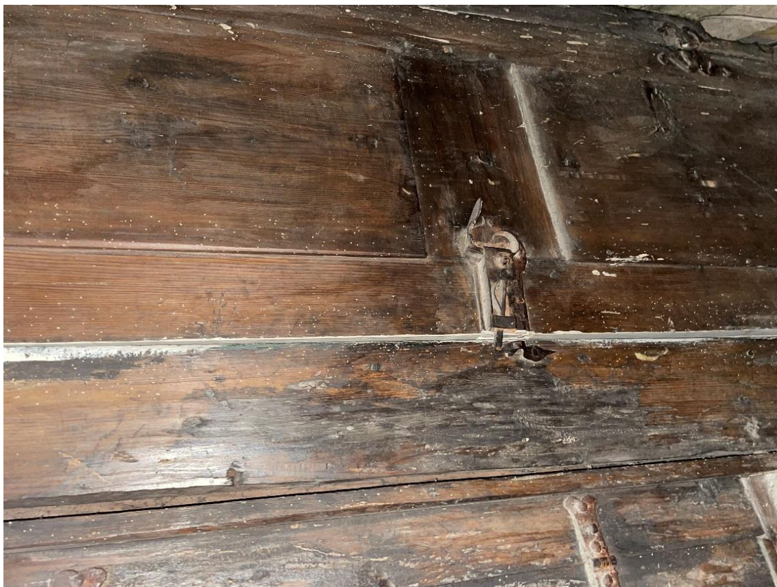
Fot.16. Więclawice Stare, kościół p.w. św. Jakuba Apostoła, ołtarz główny. Odwrocie drzwiczek umieszczonych z lewej strony ołtarza. Widoczne uszkodzenia powierzchni drewna, powstałe na skutek urazów mechanicznych.
