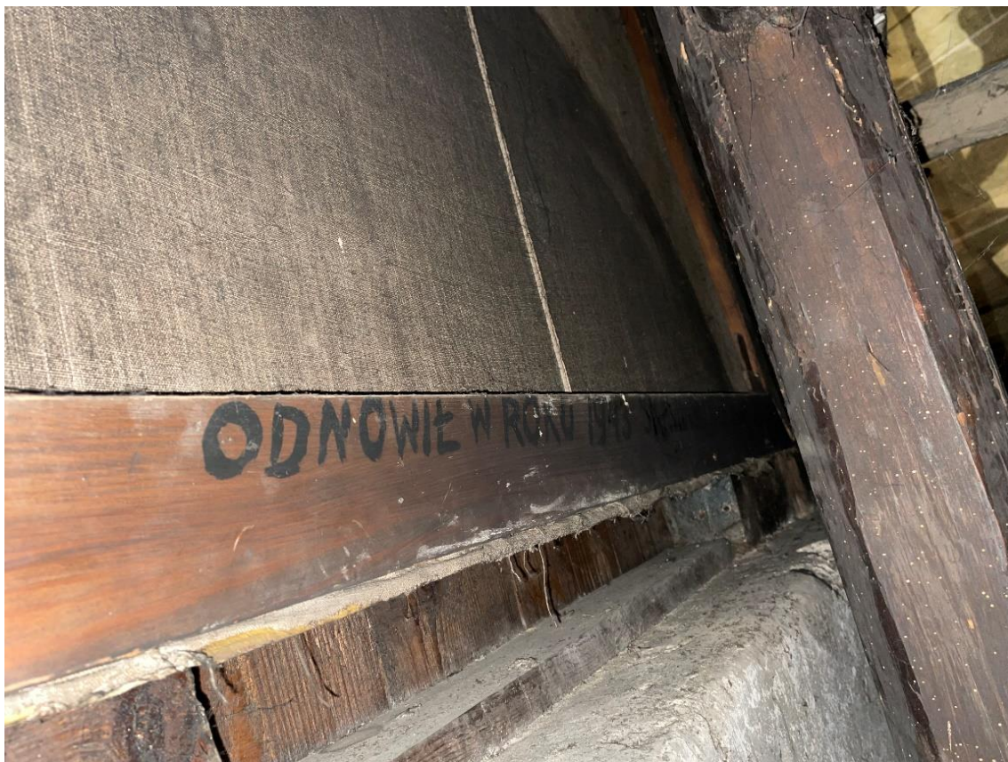
Fot.17. Więclawice Stare, kościół p.w. św. Jakuba Apostoła, ołtarz główny. Na zdjęciu widoczne zniszczenia belek konstrukcyjnych wzmacniających szafę ołtarzową od tyłu (uszkodzenia drewna powstałe na skutek urazów mechanicznych)), fragment odwrocia obrazu przedstawiającego św. Jakuba (zauważalne silne zabrudzenie podobrazia nalotem kurzu) oraz ubytki w obrębie mensy.
