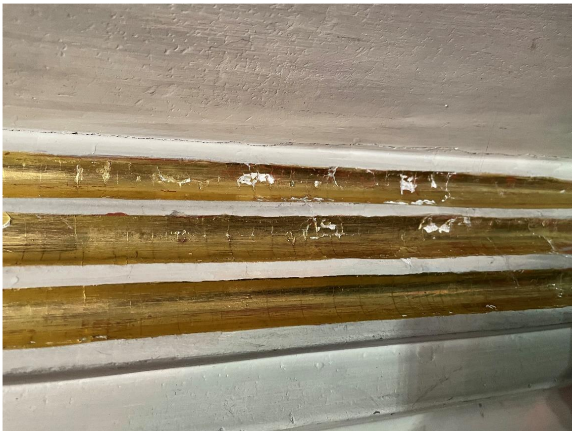
Fot.4. Więclawice Stare, kościół p.w. św. Jakuba Apostoła, ołtarz główny. Na fotografii uchwycono destrukcję nawarstwień technologicznych występującą na kanelowanych pilastrach, w bocznej części szafy ołtarzowej (spękania zaprawy, złocen, liczne ubytki).
